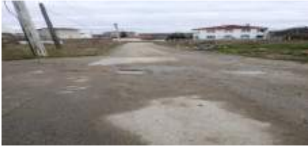
Cumhuriyet Mahallesi Zümrüt Sokak Asfalt Kırığı 800 m 2
