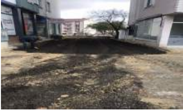
Ayaspaşa Mahallesi Nazırlar Cad. Ara Sokak Asfalt Kırığı 100 m 2
