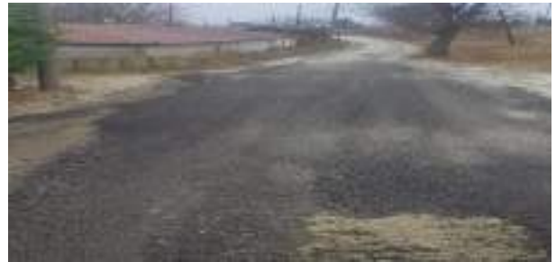
Bozoba Mah. 2455. Sokak Asfalt Kırığı 100 m 2
