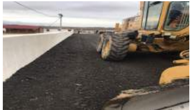
Ayaspasa Mahallesi Ladin Sokak Asfalt Kırığı 700 m 2
