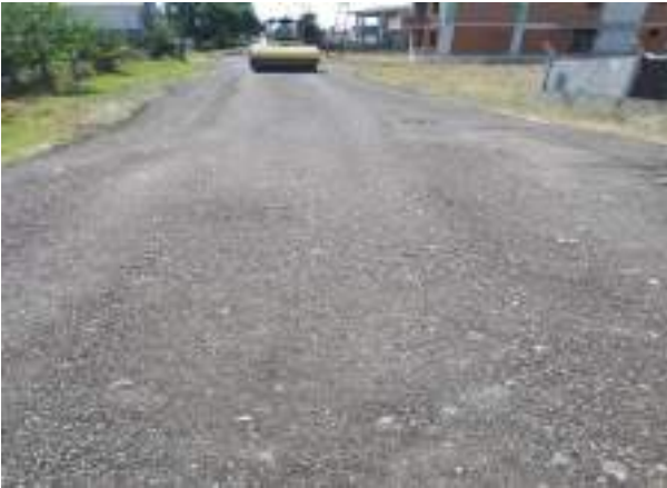
Yeni Mahalle Kayrak Sokak Asfalt Kırığı 2750 m 2
