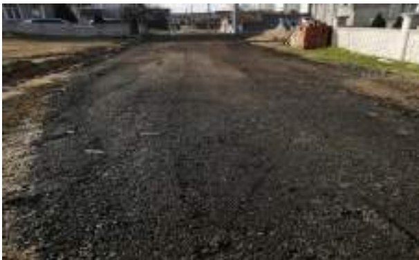
Bozoba Mahallesi 2988. Sokak Asfalt Kırığı 100 m 2
