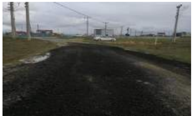
Bozoba Mahallesi 1585. Sokak Asfalt Kırığı 100 m 2
