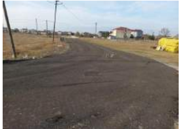
Pazarcık Mahallesi Naz Sokak Asfalt Kırığı 1350 m 2
