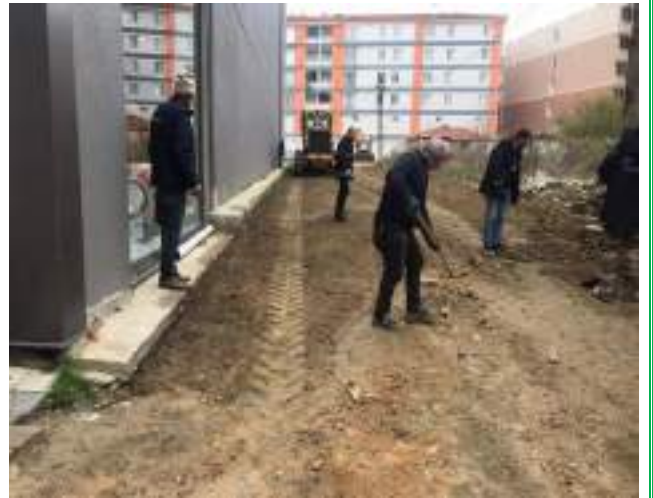
Ayaspaşa Mahallesi Çerkezköy Caddesi Ara Sokak Parke Taşı 300 m 2
